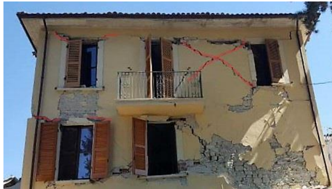
Figura 18. Tipiche lesioni a seguito di evento sismico [9].
