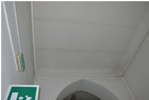
Fig. 2.13 Impronta di due travi sul solaio.
