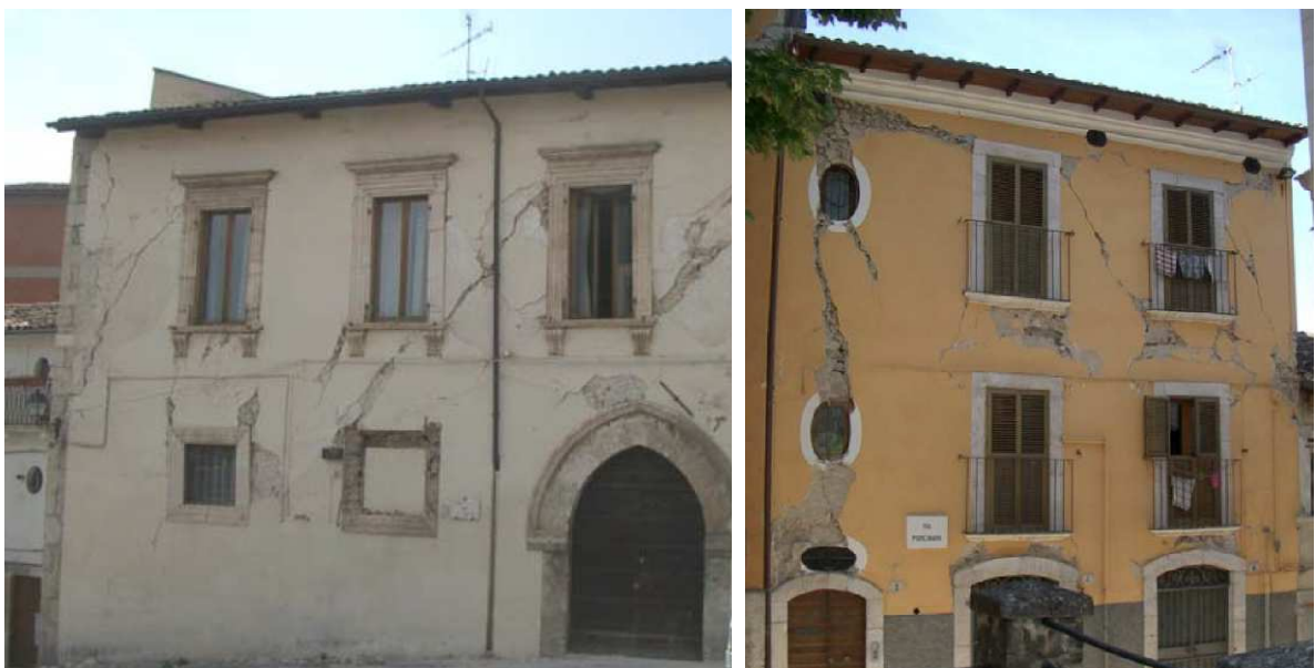
Fig.2 –Esempi di edifici in muratura ordinaria con funzione abitativa. Dissesti Sismici – l'Aquila 2009 (Prof. Ing. B. Calderoni – DIST Università di Napoli).
