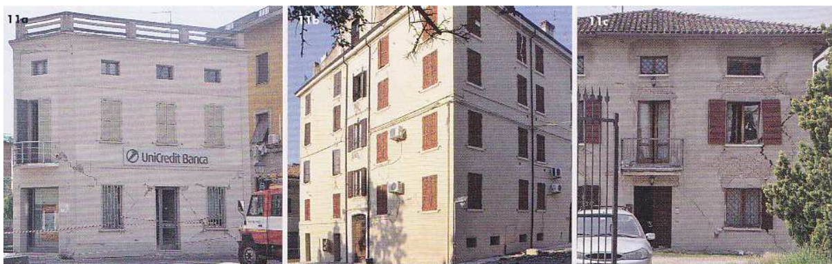
Fig.25 – Meccanismi di collasso per effetti nel piano delle pareti. Maglia, Mirandola e Rovereto sul Secchia. (da Comportamento degli edifici in muratura nella sequenza sismica del 2012 in Emilia, Progettazione sismica n° 3/2012 Iuss Press Pavia).
