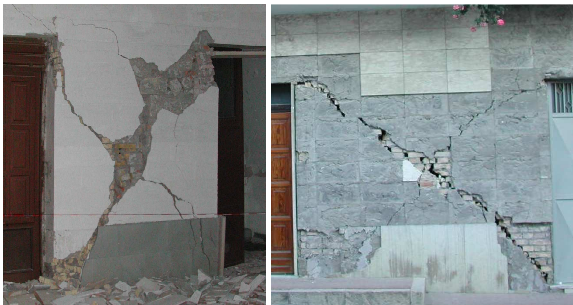
Fig. 20 - Foto1: Meccanismo di rottura a pressoflessione. Foto 2 Meccanismo di rottura a taglio per fessurazione (Foto Prof. N. Augenti).
