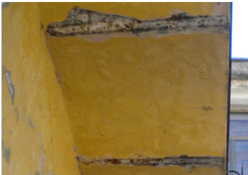
Fig. 65 –SOLAIO COPERTURA, degrado del calcestruzzo, rottura dei laterizi, fenomeni di ossidazione delle barre in acciaio, espulsione del copriferro
