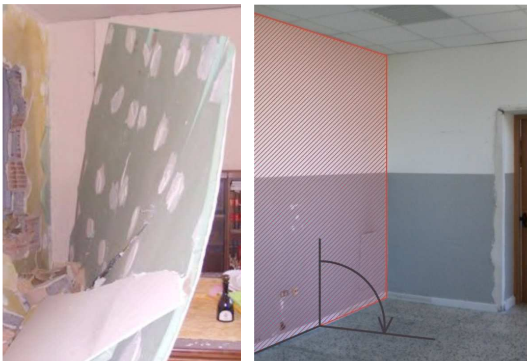
Fig. 90 Partizioni interne in cartongesso: danni Sisma L'Aquila 2009 (Linee guida Reluis 2009) – Vulnerabilità sismica delle pareti Scuola Media Comune di Sant'Arcangelo.
