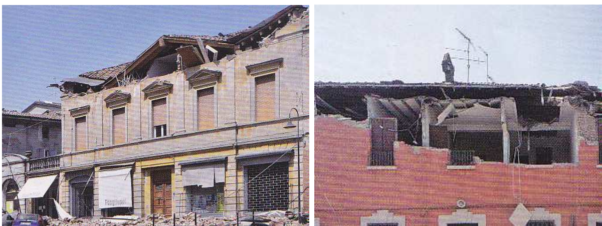
Fig.24 – Collapsi parziali fuori dal piano delle pareti perimetrali causate da coperture in legno spingenti nei centri storici di Concordia sulla Secchia e Maglia (da Comportamento degli edifici in muratura nella sequenza sismica del 2012 in Emilia, Progettazione sismica n° 3/2012 Iuss Press Pavia).
