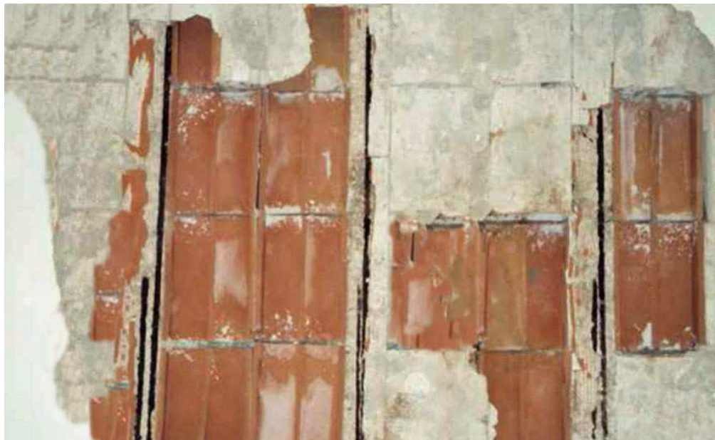
Fig. 64 –SOLAIO IN LATERO-CEMENTO DI COPERTURA, degrado del calcestruzzo, rottura dei laterizi, fenomeni di ossidazione delle barre in acciaio, espulsione del copriferro
