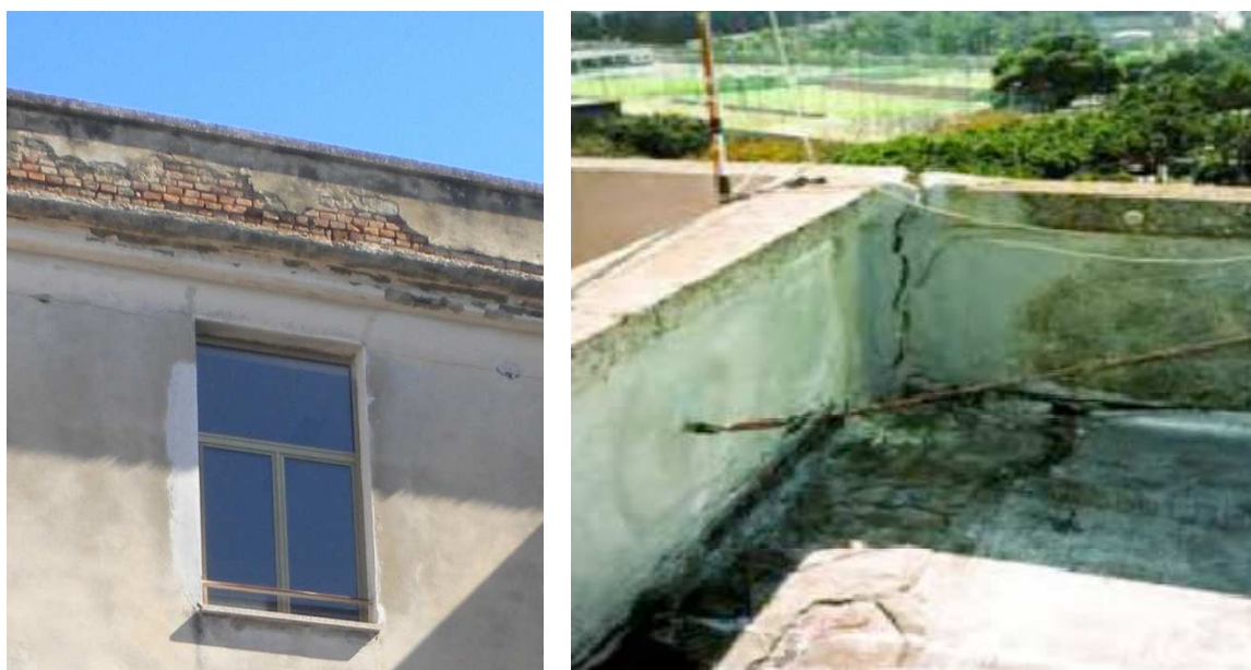
Fig. 92 Parapetti e cornicioni. Danni Sisma L'Aquila 2009 (linee guida Reluis 2009) – Elevata vulnerabilità Scuola Media Comune di Sant'Arcangelo.
