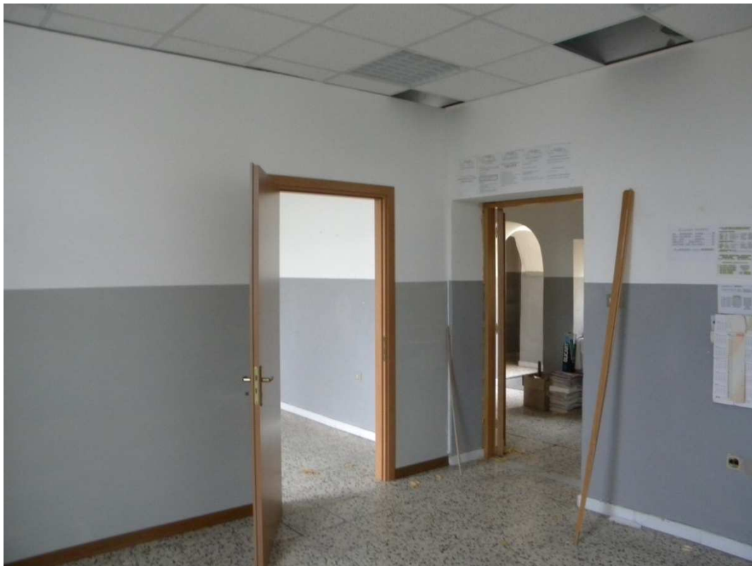
Fig. 63 Istituto Scolastico Superiore di primo grado (Scuola Media) - Comune di Sant'Arcangelo. Struttura spingente con volta a botte atrio scuola media; struttura con solaio piano in latero-cemento e controsoffittatura PP Scuola.
