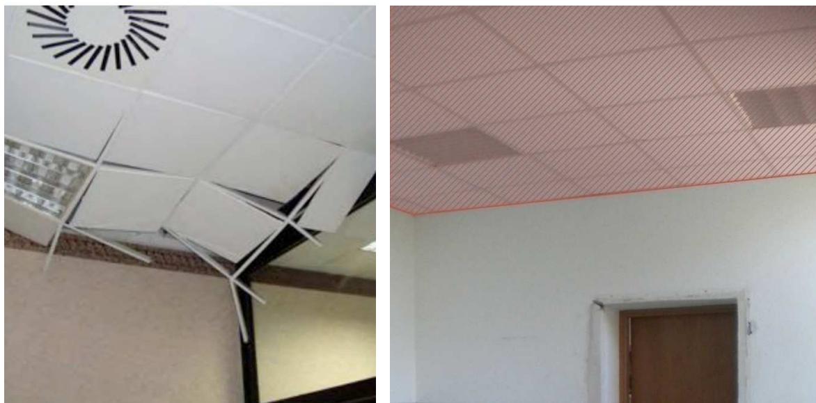
Fig. 91 Controsoffitti. Danni Sisma L'Aquila 2009 (linee guida Reluis 2009) – Elevata vulnerabilità Scuola Media Comune di Sant'Arcangelo.
