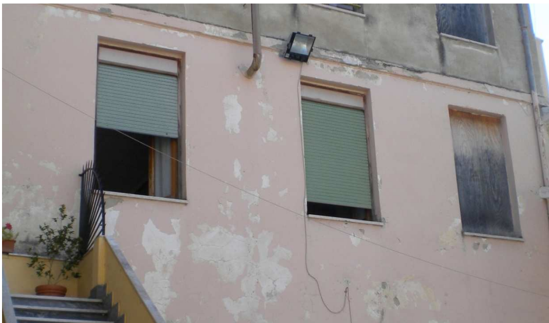
Fig. 67 – Stato di degrado dell’intonaco di rivestimento parete convento; disgregazione dei cordoli in c.a. con ossidazione delle barre di armatura; disgregazione e caduta di sezioni del parapetto di copertura;
