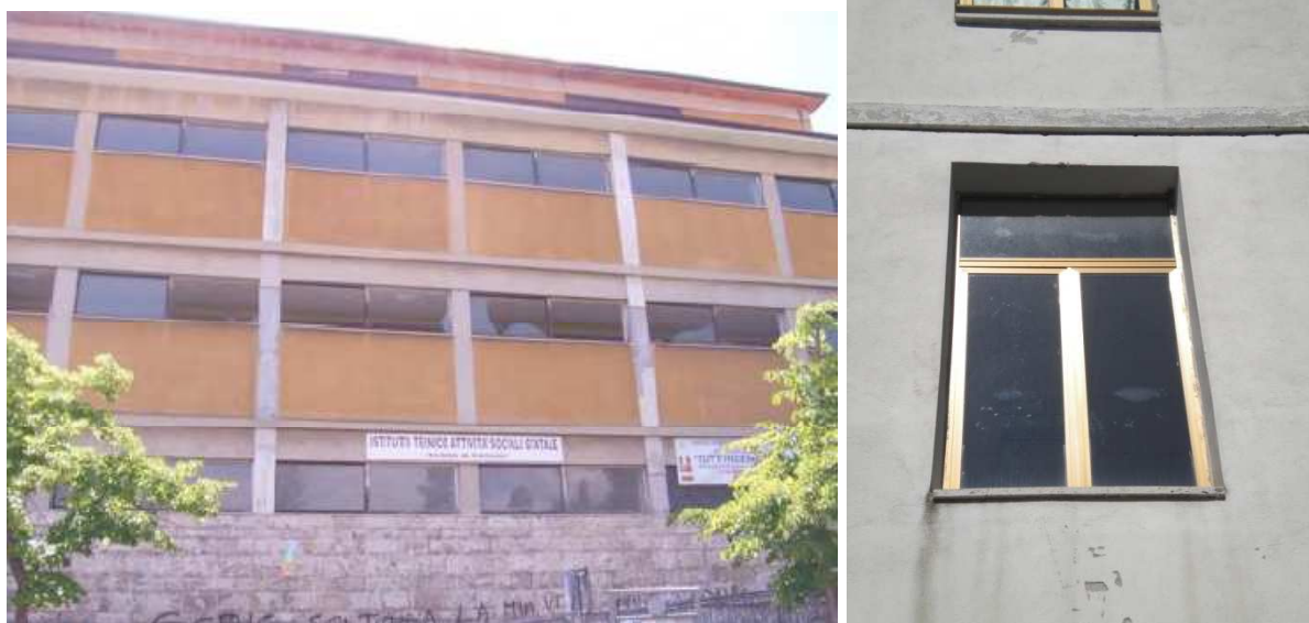
Fig. 93 Superfici finestrate. Danni Sisma L'Aquila 2009 (linee guida Reluis 2009) – Elevata vulnerabilità Scuola Media Comune di Sant'Arcangelo.
