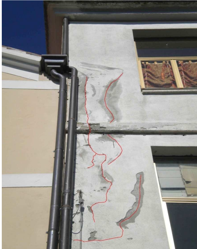
Fig. 66 – Meccanismo di danno “da irregolarità tra strutture adiacenti”, la lesione ad andamento verticale lungo la linea di interfaccia (V18) può derivare da un cedimento differenziale verticale tra le strutture data l’entità diversa dei carichi gravitazionali trasmessi al terreno.
