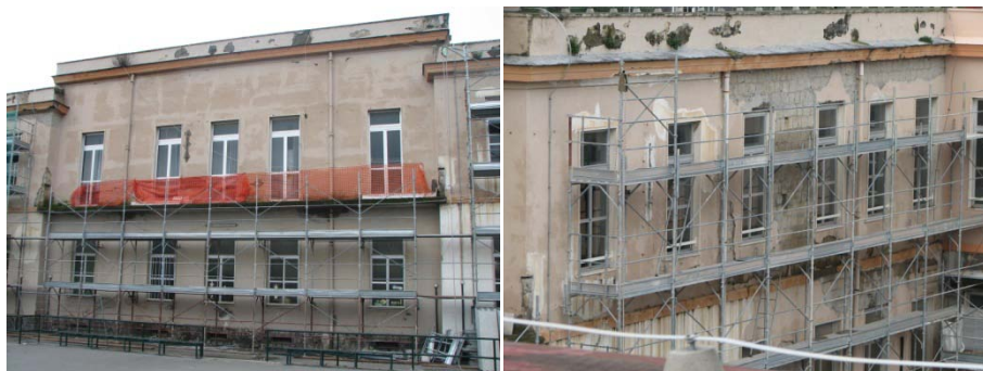
Figura 72: Particolari esterni scuola N.Sauro:Diffuse lesioni degli intonaci.
