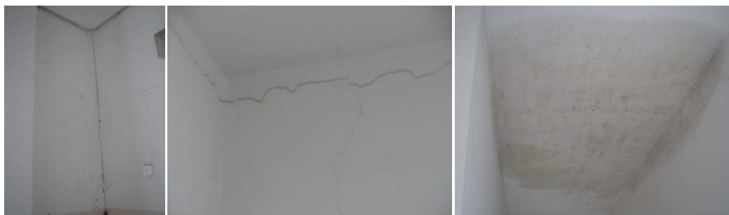
Figura 73: Particolari lesione degli interni scuola N.Sauro :
