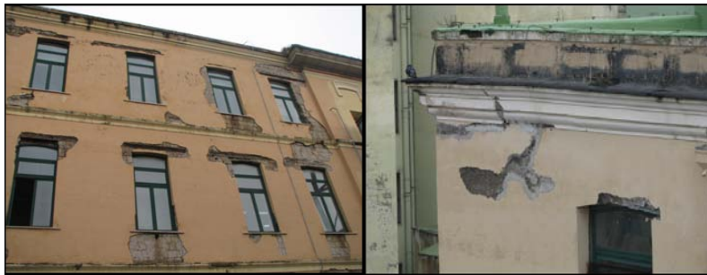
Figura 32: Particolari esterni scuola G.Mazza :Diffuse lesioni degli intonaci.
