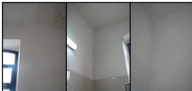
Figura 33: Particolari degli interni scuola G.Mazza :Lesioni da schiacciamento della muratura
