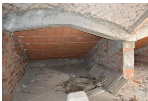
Figura 2.17 Solaio e travi in sostituzione di una volta crollata
