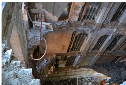
Figura 3.9 Zona del crollo
