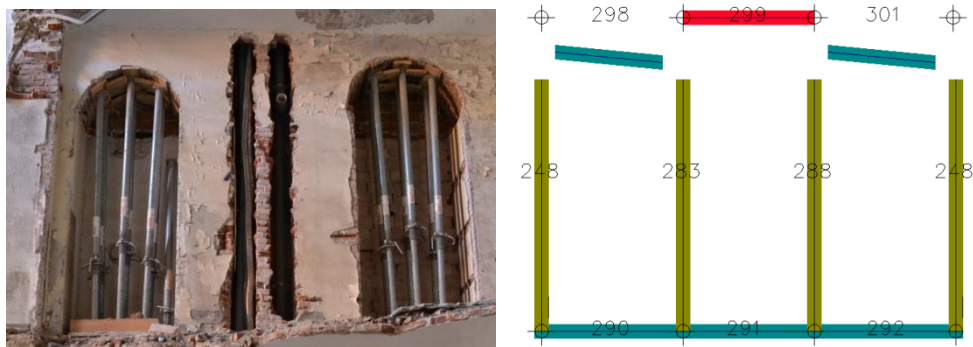
Figura 6.4 a) Canne fumarie in una parete fra pilastri b) Mesh della parete con canne fumarie
