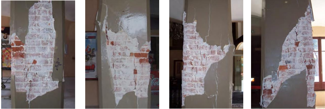
Figura 3.2 Lesioni sui quattro lati del pilastro B4
