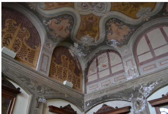
Figura 3.1 Macchie di umidità nella Sala Germinal
