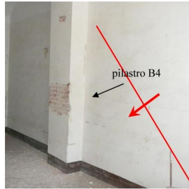
Figura 3.6 Lesione a taglio nella parete del primo piano posta sopra la biglietteria
