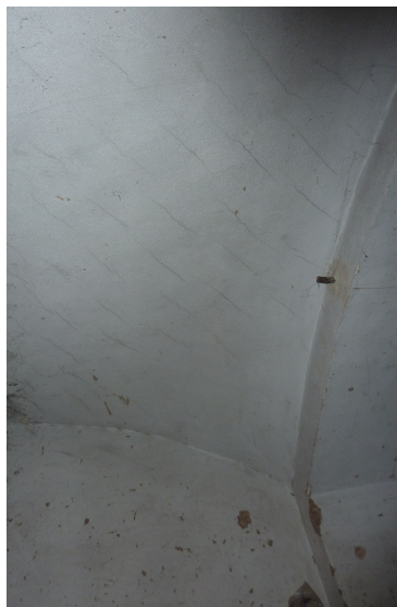
Fig. 6.1.12: lesioni sulla volta a vela
