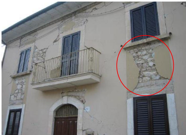
Figura 62: esempio di rottura della fascia di piano
