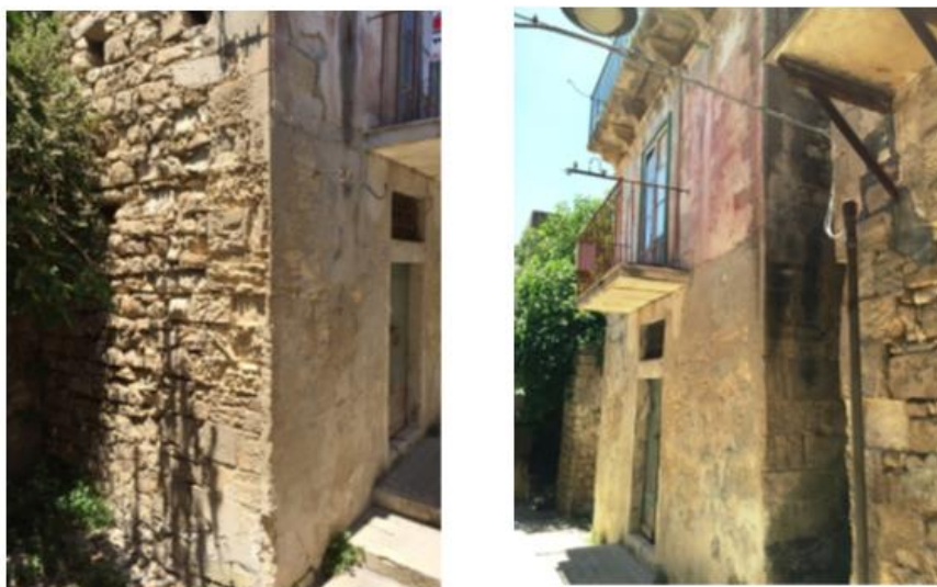
Figura 23: presenza di buon ammorsamento nel caso di studio, si nota l'assenza di cordoli/catene
