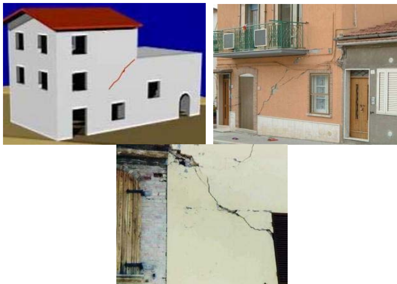
Fig. 2.18 Lesioni diagonali nella zona di variazione di altezza
