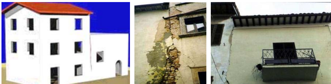
Fig. 2.19 Lesioni verticali nella zona di variazione di altezza
