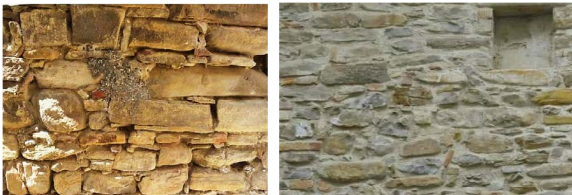
Fig 5.17 Esempi di muratura a conci sbozzati e in pietra a spacco presenti nel Comune di Arsita
