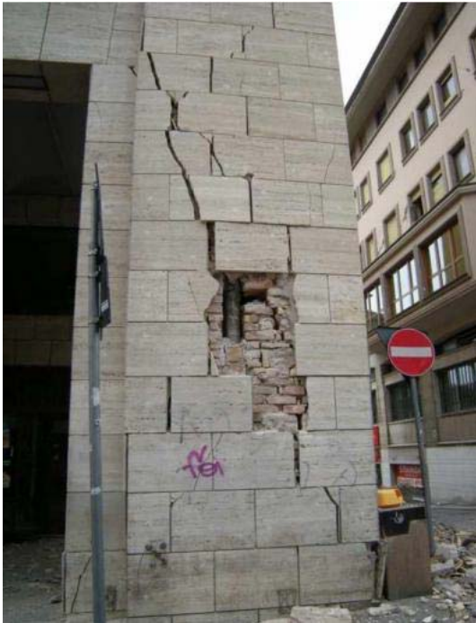
Fig. 5.2 Danneggiamenti alle strutture murarie in seguito al sisma nella città di L'Aquila
