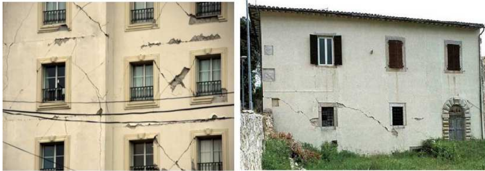
Figura 1.10 Quadro fessurativo a seguito dell'attivazione di meccanismi nel piano.
