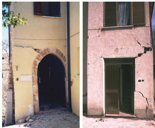
Figura 3.6 Configurazione post sismica di parete esistente. Quadro fessurativo meccanismo rottura taglio – scorrimento.
