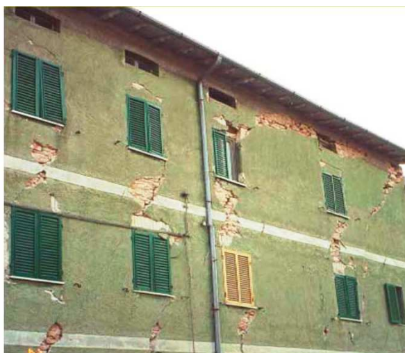
Figura 3.13 Configurazione post sismica di parete esistente. Quadro fessurativo meccanismo rottura delle fasce per taglio.
