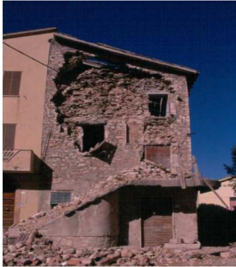
Figura 3-2. Esempio di disgregazione muraria
