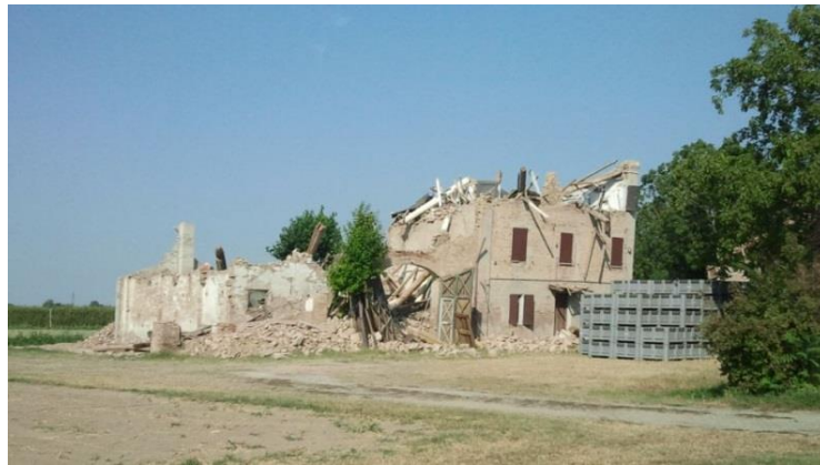
Figura 3-25. Danni provocati dal terremoto agli edifici rurali
