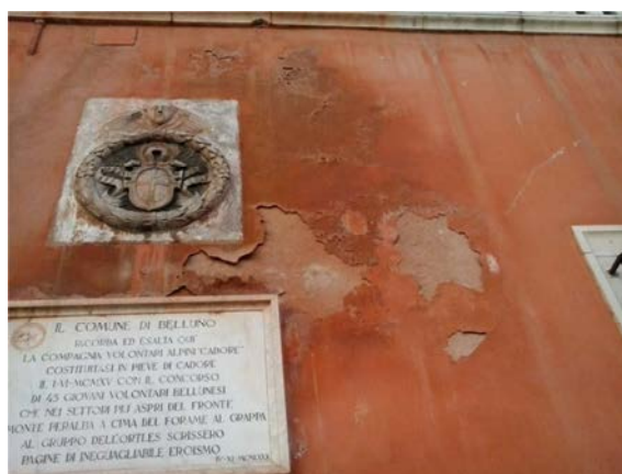
Figura 4.2-23: Esempio di distacco di intonaco.
