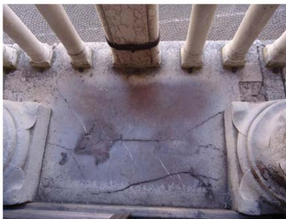
Figura 4.2-9: Fessure nel balcone.
