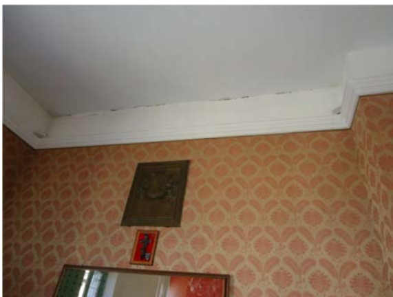
Figura 4.2-6: Fessura nella sala della giunta decorativa.
