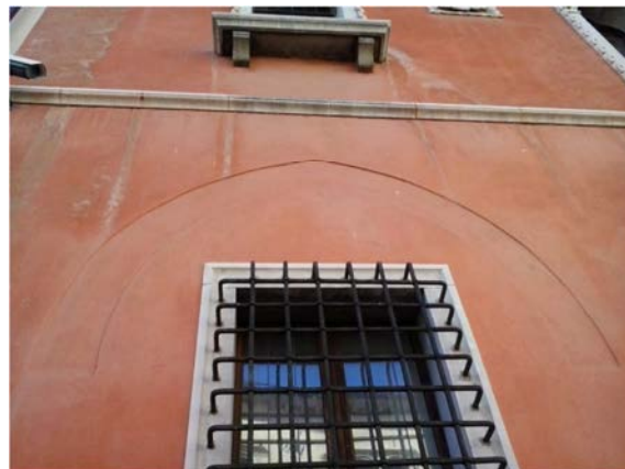
Figura 4.2-19: Esempio di dilavamento.
