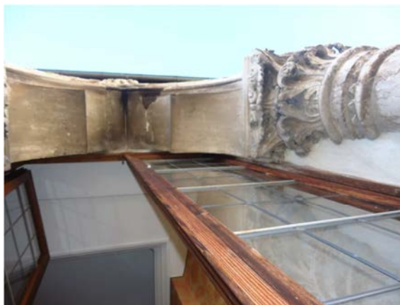
Figura 4.2-7: Esempio di degrado dell'apparato.
