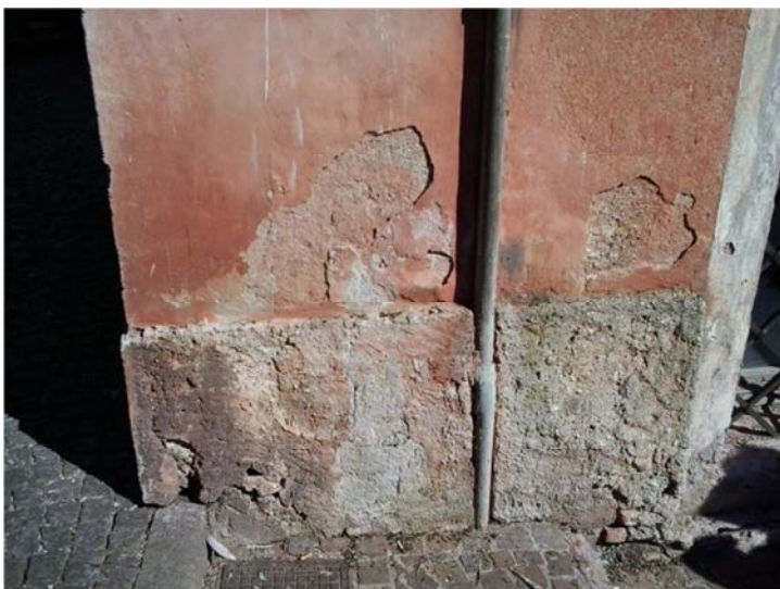
Figura 4.2-26: Degrado imputabile all'umidità.
