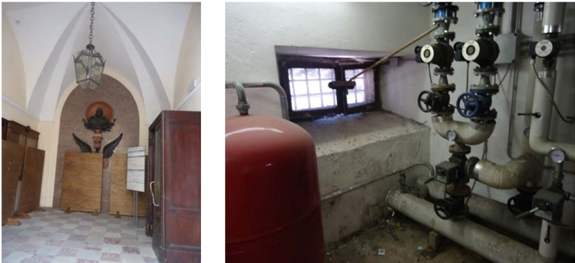
Figura 2.2-1: Androne di ingresso e particolare del locale caldaia.
