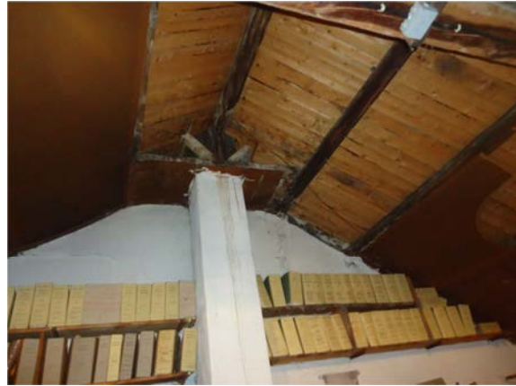
Figura 4.2-17: esempio di degrado nel sottotetto.
