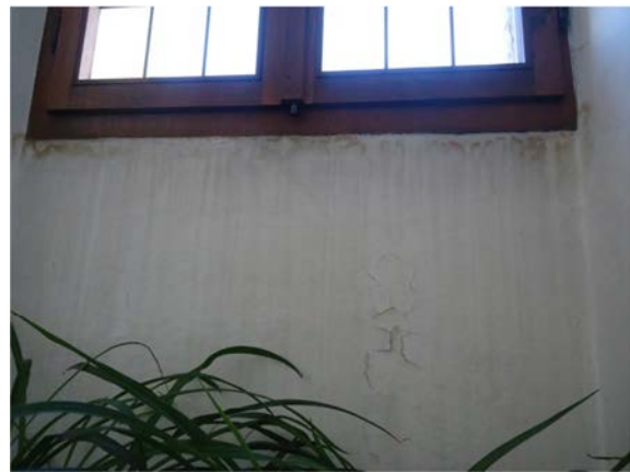
Figura 4.2-11: Esempio di dilavamento.
