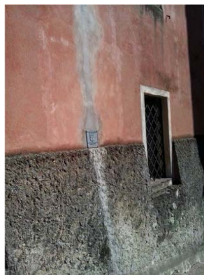
Figura 4.2-27: Alterazione non accidentale.
