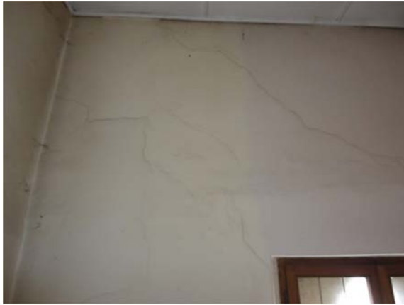
Figura 4.2-16: Fessurazione nel vano di accesso alla soffitta.
