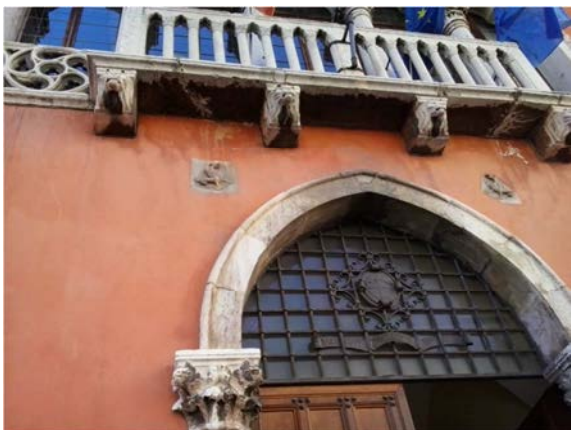
Figura 4.2-20: Esempio di degrado elementi lapidei.
