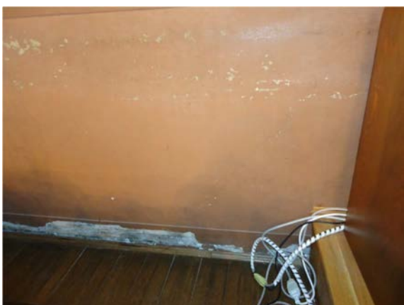
Figura 4.2-14: Degrado nella sala consigliare.
