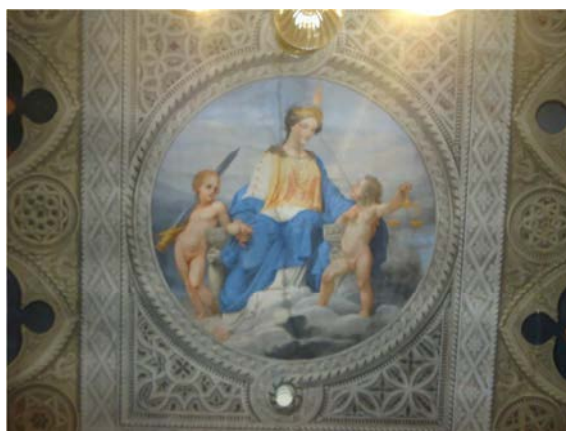
Figura 4.2-15: Soffitto fessurato nella sala consigliare.
