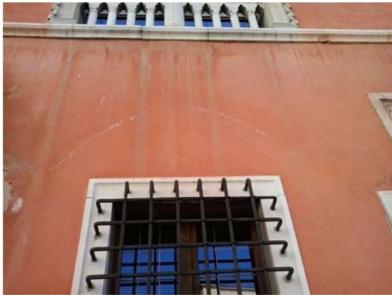
Figura 4.2-24: Esempio di dilavamento.
