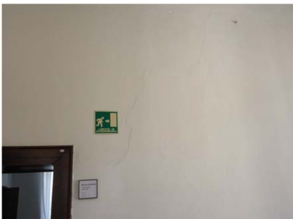
Figura 4.2-12: Fessurazione al secondo piano.
