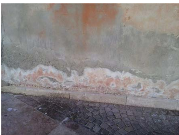
Figura 4.2-22: Esempio di umidità di risalita.
