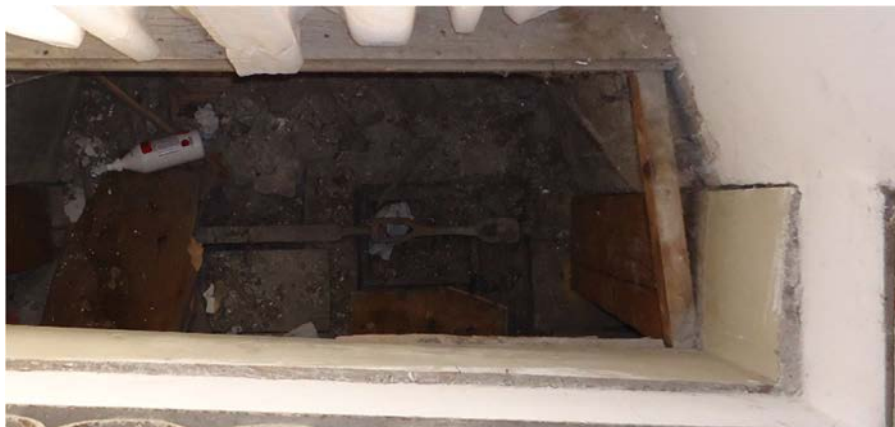
Figura 4.4-11: Vista dall'interno dell'edificio (in corrispondenza del davanzale della finestra del primo piano) del tirante numero10.
