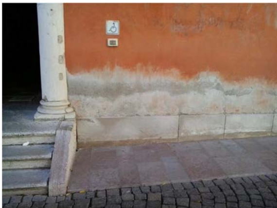
Figura 4.2-18: Risalita di umidità.
