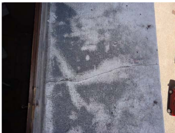
Figura 4.2-13: Fessurazione del davanzale.
