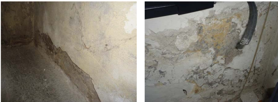
Figura 4.2-1: Esempi di degrado causato da umidità, nel seminterrato.
