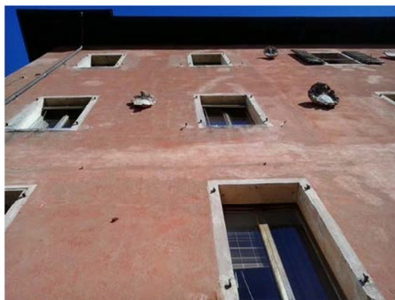
Figura 4.2-29: Degrado generale della facciata.
