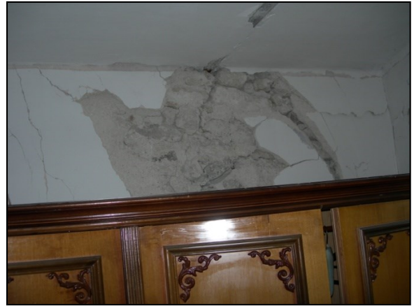
Fessurazione diffusa del pannello murario con crollo localizzato della muratura.
