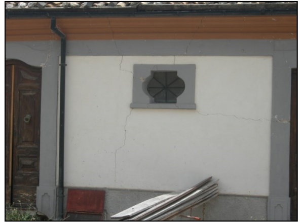
Fessurazione nel piano
