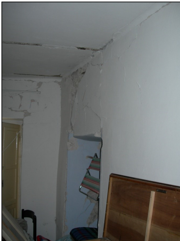
Fessurazione del pannello di fascia
