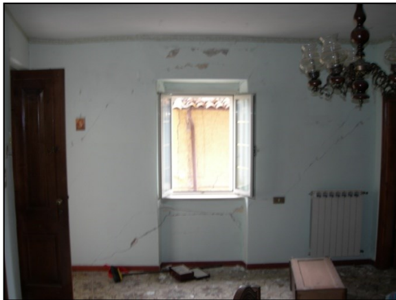
Lesioni diffuse nella parete
