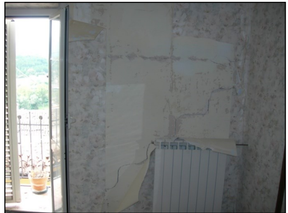
Lesione passante a taglio scorrimento nel pannello murario del secondo piano
