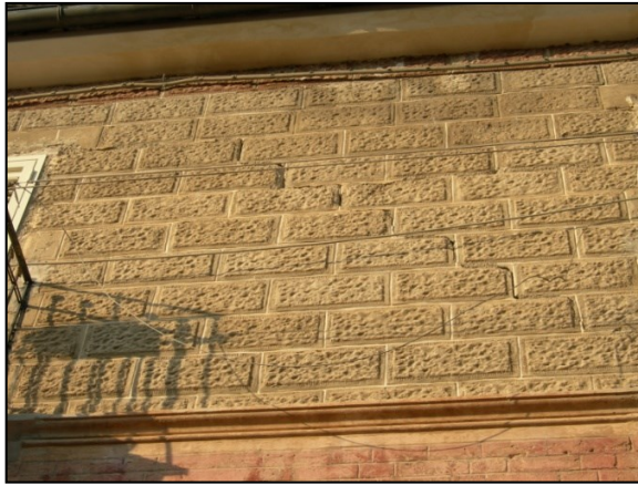
Fessurazione a taglio scorrimento sul pannello di maschio
