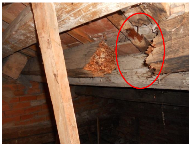
Figura III.25 : Degrado causato da un'infiltrazione d'acqua
