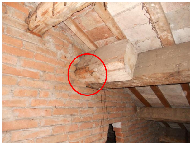
Figura III.24 : Degrado in corrispondenza dell'appoggio sul timpano murario
