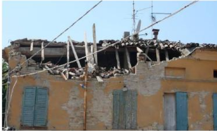
Figura I.51 : Meccanismi locali fuori dal piano in sommità alla facciata, a San Felice sul Panaro.
