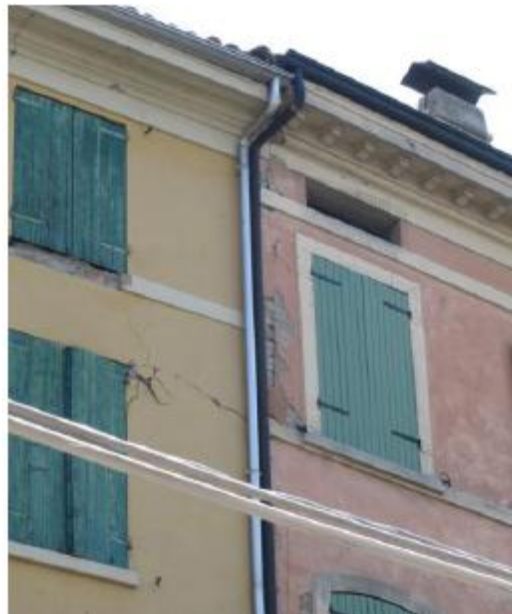
Figura I.53 : Danni da interazione e martellamento in edifici in aggregato (Mirandola).
