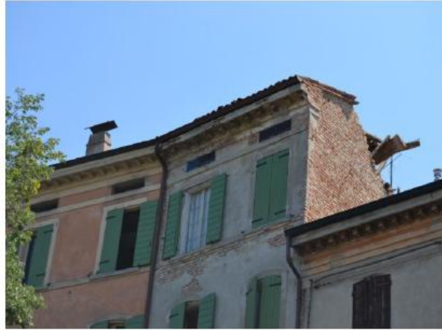
Figura I.52 : Ribaltamento di porzioni sommitali per irregolarità in elevazione negli edifici in aggregato (Mirandola).
