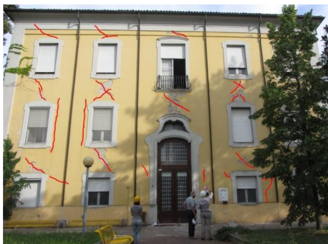
Figura I.50 : Danno per azioni nel piano concentrato nelle fasce murarie (Finale Emilia); (nella foto le lesioni sono evidenziate in rosso)
