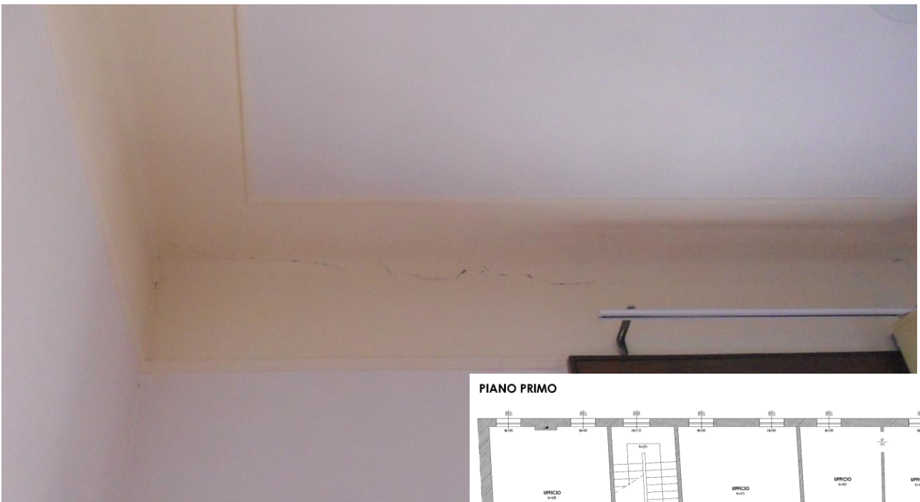
Figura III.29: Foto delle lesioni nel disimpegno al primo piano e relativa localizzazione in pianta
