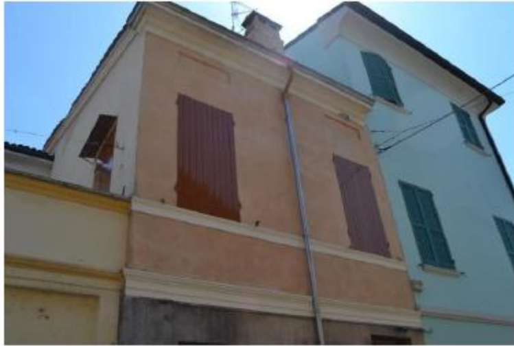
Figura I.54 : Lesioni a taglio nei maschi degli edifici in aggregato a schiera (Mirandola); la cella ha un maschio lesionato a taglio al primo piano a causa di un contrasto non simmetrico con le celle adiacenti.
