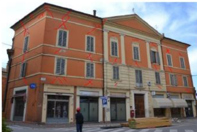
Figura I.49 : Danno per azioni nel piano concentrato nelle fasce murarie (Finale Emilia); (nella foto le lesioni sono evidenziate in rosso)
