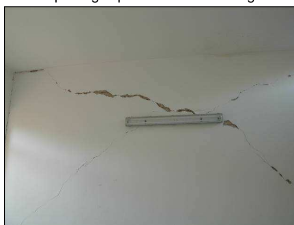
Figura: Particolare della rottura di un maschio interno all'edificio per rottura per taglio per fessurazione diagonale
