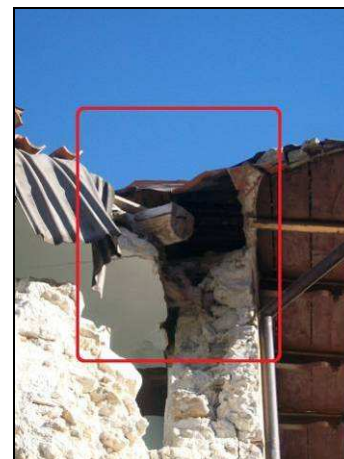
Figura: Particolare della copertura spingente sulla parete 1
