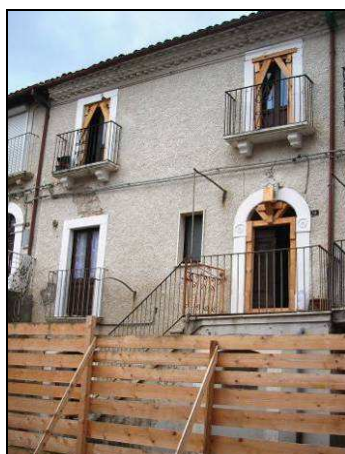
Figura: Parete su cui si è attivato il meccanismo di ribaltamento
