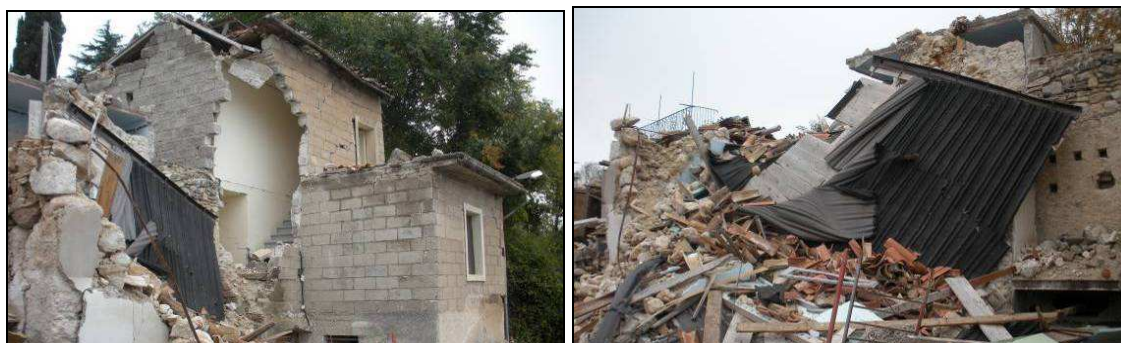
Figura: vista degli aggregati 237 e 244 dopo il sisma
