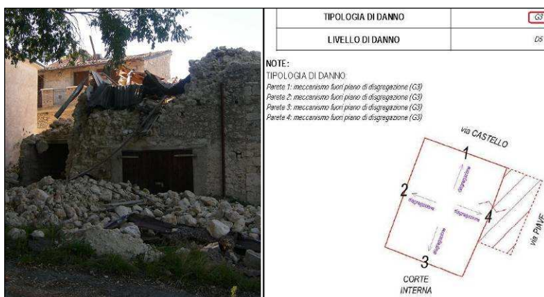
Figura: Esempio di US in cui è stata assegnata la classe di crollo invece di meccanismo fuori piano (G3) su tutte le pareti
