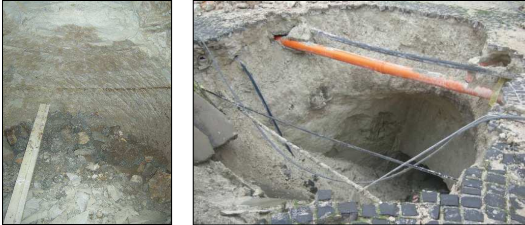
Figure: Particolare di una cavità scavata nell'ammasso roccioso e immagine di una voragine di una strada in corrispondenza del crollo della calotta superiore della grotta
