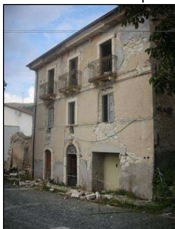
Figura: Parete interessata dal meccanismo
