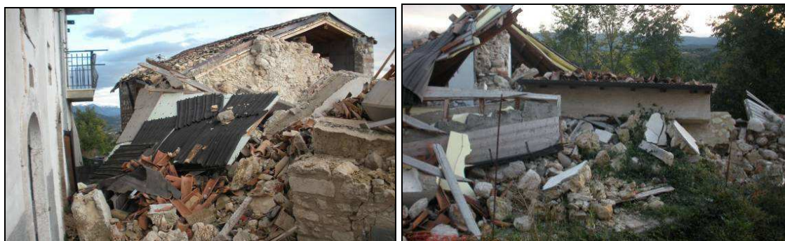
Figura: vista dell'aggregato 049 dopo il sisma
