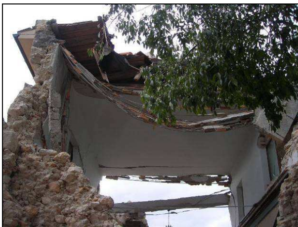
Figura: Particolare della parete crollata e della copertura dell'US
