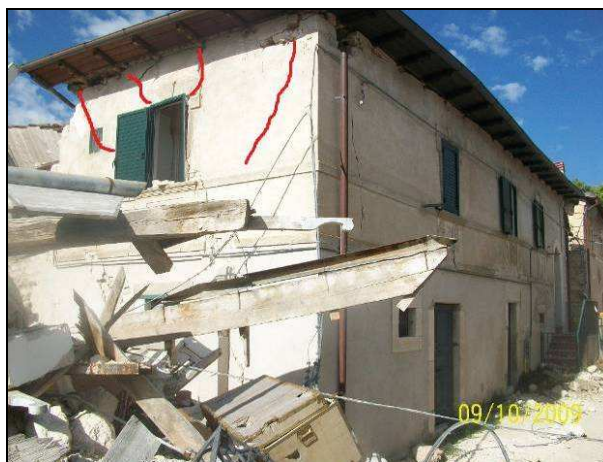
Figura: Particolare dell'andamento delle lesioni sulla parete
