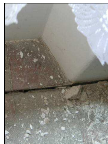
Figura: Distacco della pavimentazione
