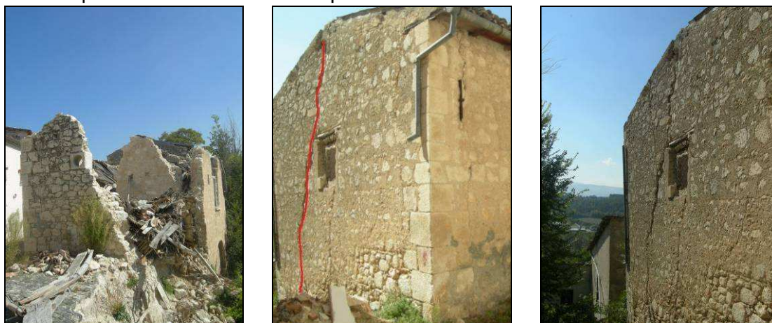
Figure: Meccanismo di ribaltamento della parete 3 e particolari delle lesioni a semplice diagonale sulle pareti di controvento laterali
