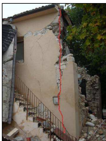
Figura: Lesione verticale che individua il ribaltamento della parete
