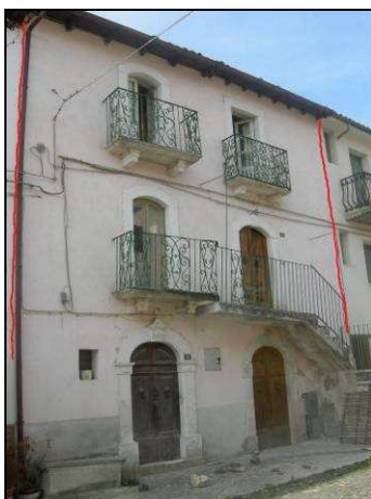
Figura: Lesioni verticali esterne sulla parete ai vari livelli dell'US
