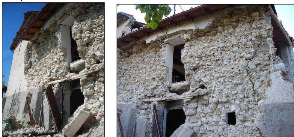
Figure: Ribaltamento della parete 3 dell'US con crollo della sola cortina esterna
