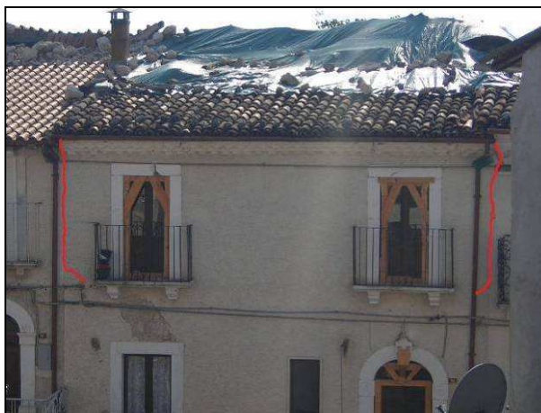
Figura: Lesioni verticali esterne sulla parete dell'ultimo piano
