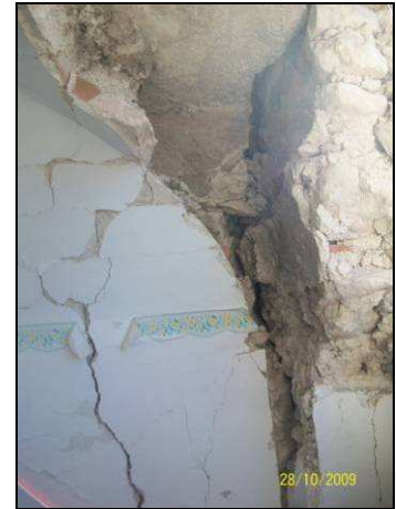
Figure: Lesioni verticali e in corrispondenza dell'orizzontamento
