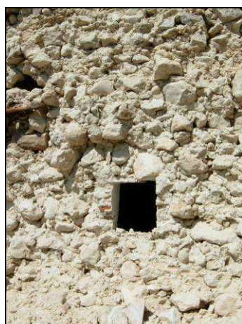
Figura: Particolare della cortina interna non crollata
