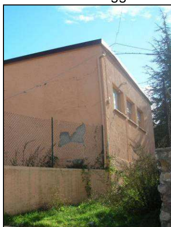
Figura: Parete esterna interessata dal meccanismo
