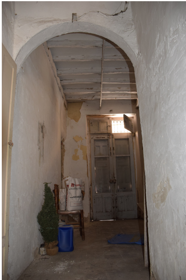
Foto 2.2.5_8 - Secondo vano presente al secondo livello e visione del solaio in legno ad unica orditura attraverso travi uso fiume 15x15cm
