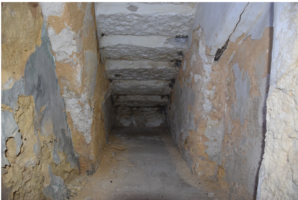
Foto 2.2.5_10 - Vano del sottoscala dove è possibile riconoscere l'ammorsamento della scala con la muratura al primo livello.
