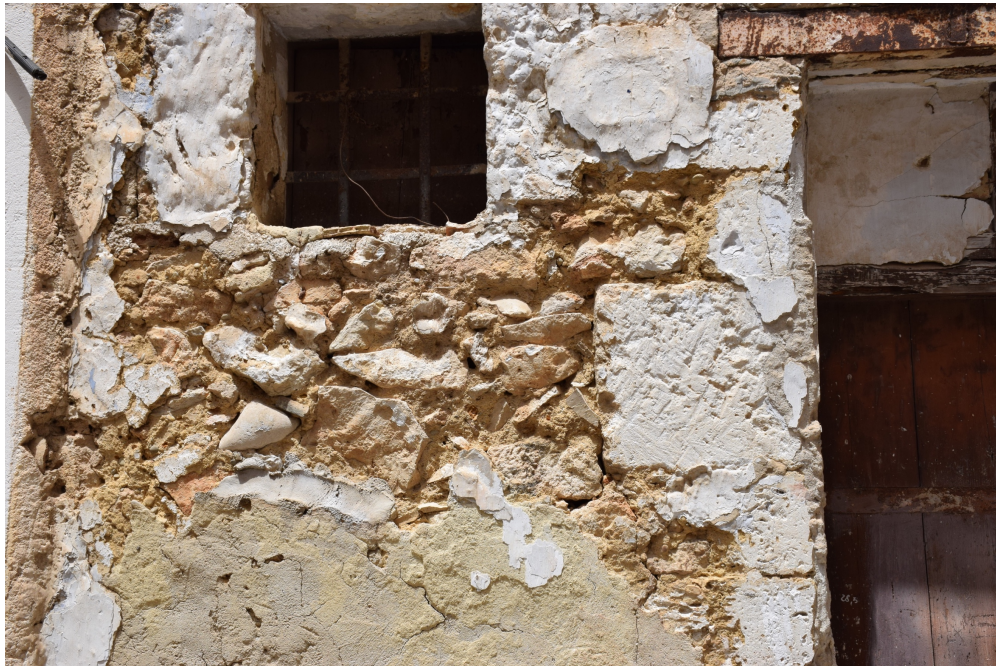
Foto 2.2.5_2 - Tessitura muraria irregolare con pietrame informe di varia pezzatura collegata tramite malta degradata
