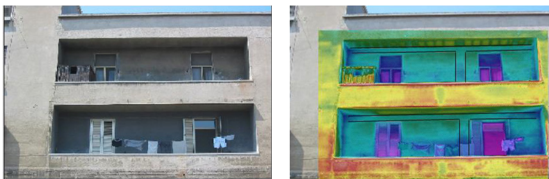
Fig.7.27 Rilevazione termografica eseguita il 27 luglio 2003 alle 14.30 | Pilastro e trave del prospetto sud della palazzina A
