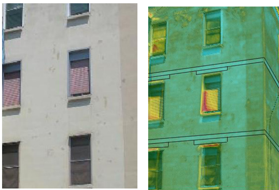
Fig.7.28 Rilevazione termografica eseguita il 27 luglio 2003 alle 14.30 | Cordoli e architravi del prospetto nord della palazzina
